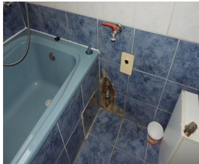
2. Mjesto puknuća cijevi
