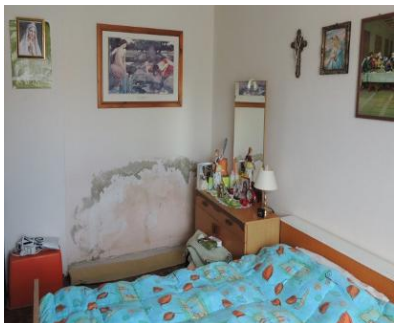
4. Izbijanje vlage sa suprotne strane zida
