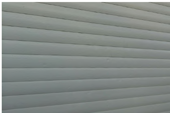
5. Oštećenja na roletama uslijed tuče
