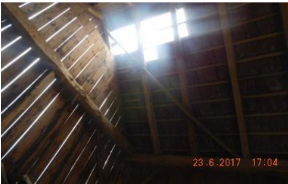
3. Šteta na krovu od oluje – foto iz unutra
